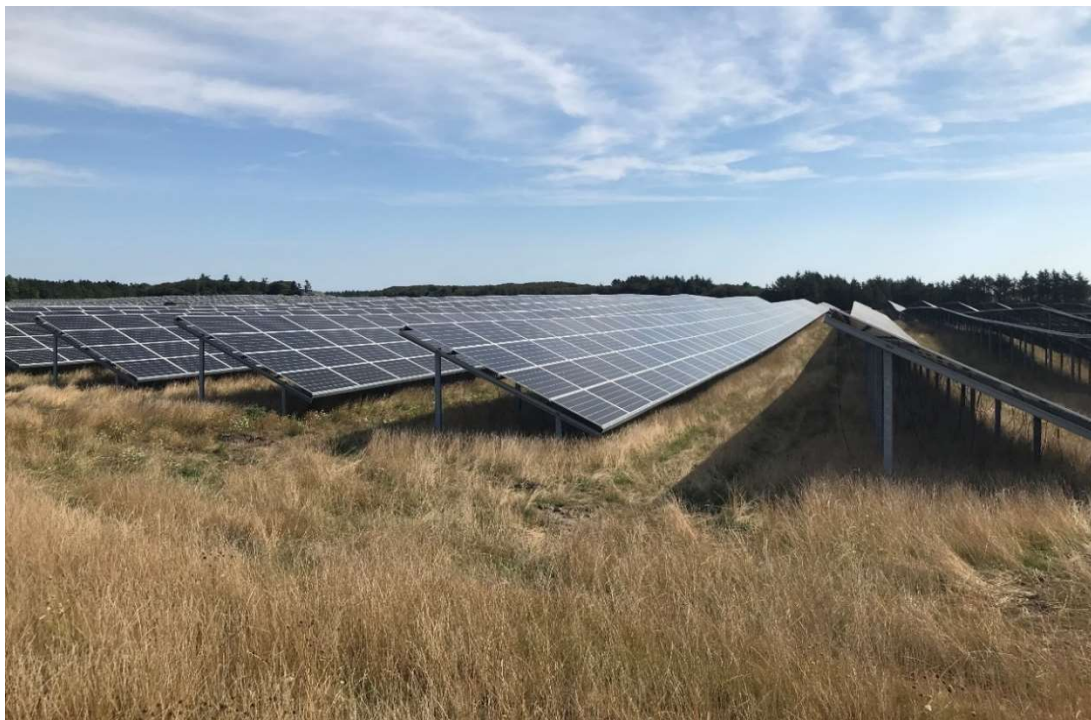
Figur 7. Solcellspaneler monterade på orörliga strukturer fast monterade med fix lutning mot solen, s.k. "Fixed Tilt" (FT).
