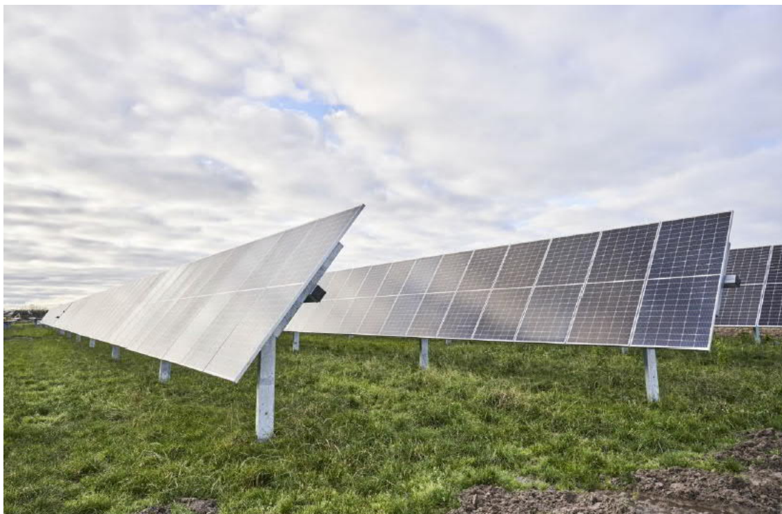
Figur 4. Solcellspaneler monterade på enaxlade solspårare (SAT).
