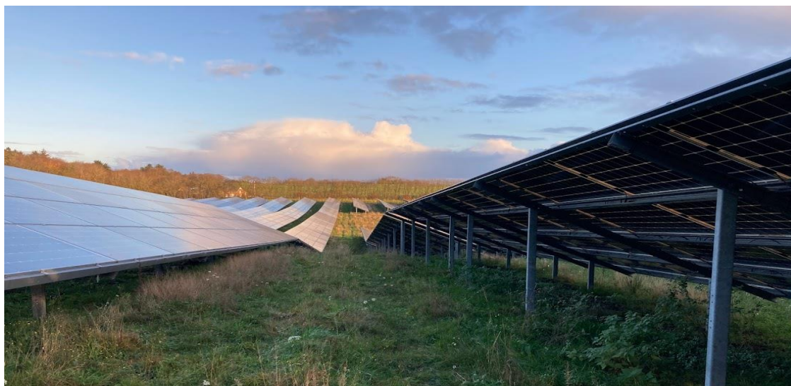
Figur 5. Solcellspaneler monterade på metallstativ.
